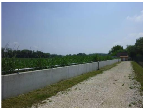
Station d'épuration en filtres à roseaux à écoulement horizontal, Jayat (01)
